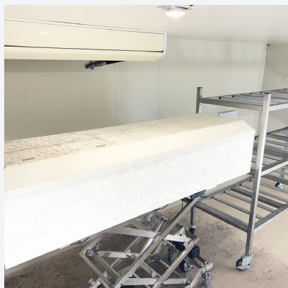
遺体用冷蔵庫 安置台 2 段目
